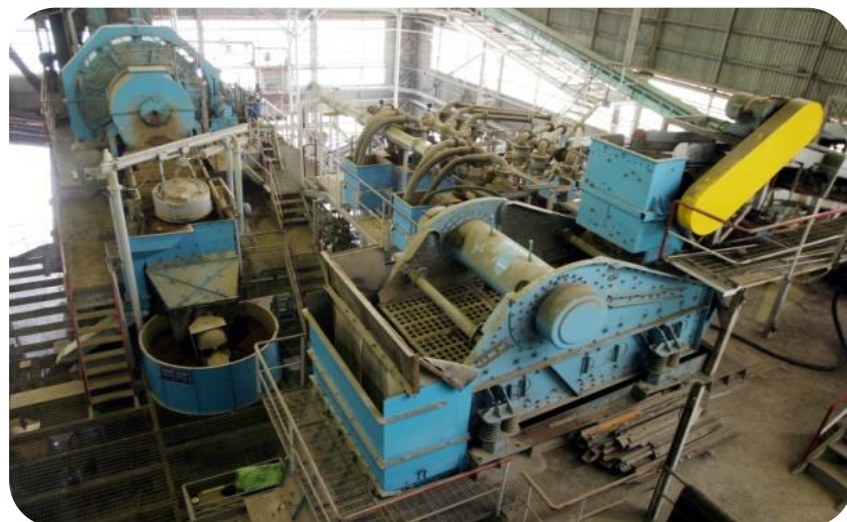
浄化等処理施設（浄化）
