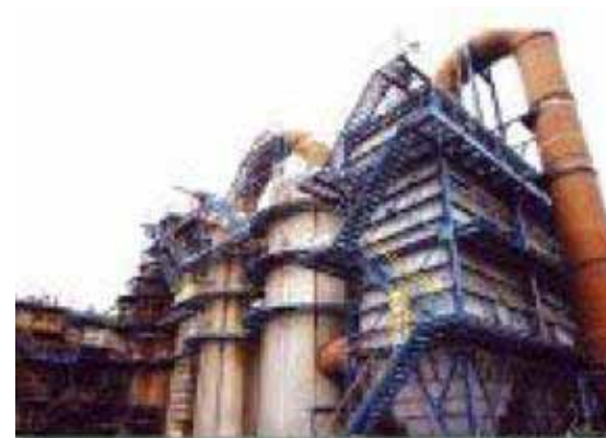
汚染土壌焼却処理施設
