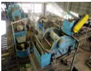
浄化等処理施設
